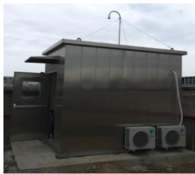
图 2 厂界环境空气中 VOCs 全在线监测系统站房
