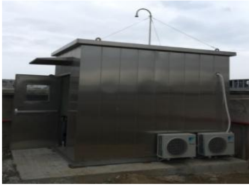
图 5 环境空气中 VOCs 全在线监测系统站房
